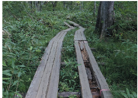
図 劣化した尾瀬の木道
