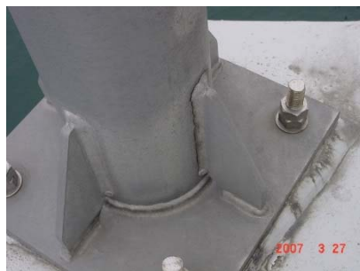
標識柱基部溶接部の亀裂
