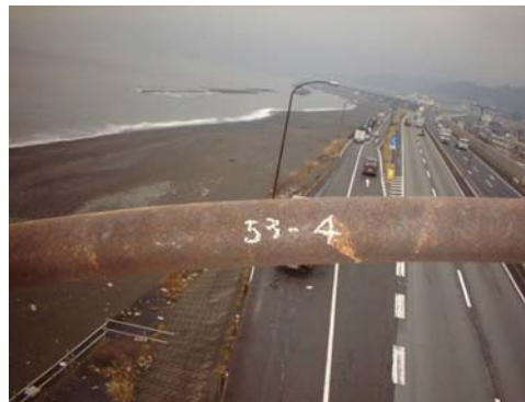
写真-解 8-11 支柱本体の腐食事例
