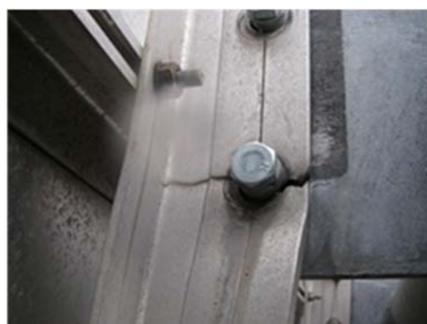
取付部の変状状況
