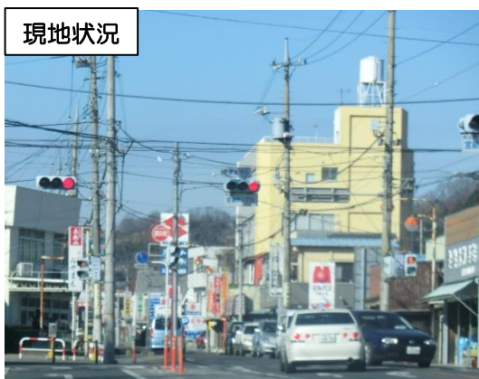
乱立する電柱・電線類
