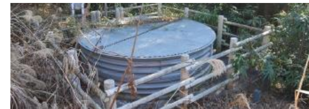
過年度実施箇所の集水井
