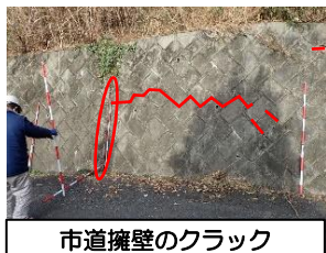
市道擁壁のクラック
