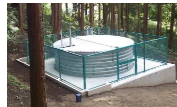
R6実施箇所の集水井
