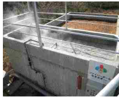
密閉型堆肥化装置に設置
