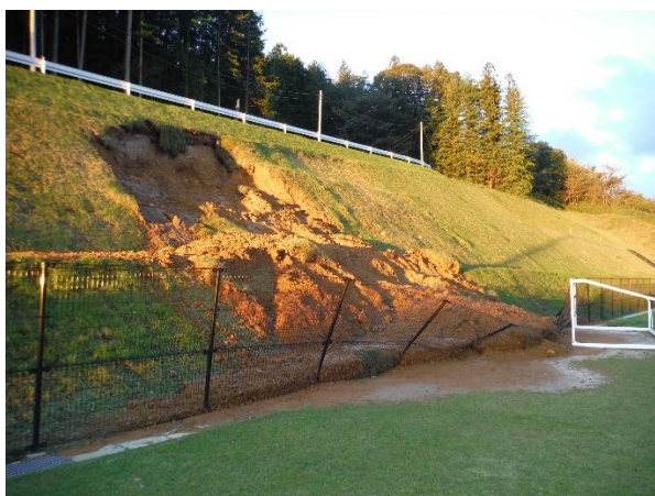
⑤ 令和元年10月 台風19号により倉渕 サッカー場の法面崩落(水沼)
