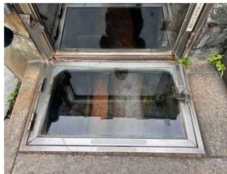
伊香保温泉の石段にある清掃口。下に温泉水が引き湯されている樋が見える。
