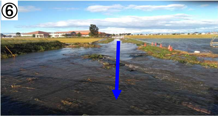
令和元年東日本台風 浸水状況
