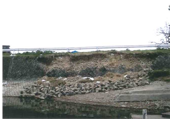
牛秣貯水池 東日本大震災の被災状況
