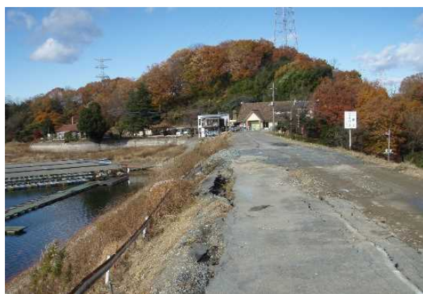
大谷池 東日本大震災の被災状況
