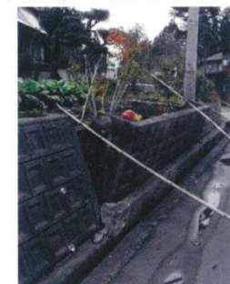
⑧ ブロック塀の転倒
