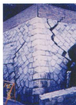
④ 擁壁隅部の亀裂
