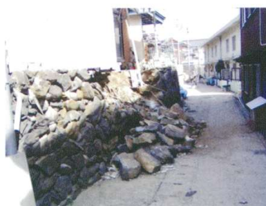
⑥ 上部に建物がある擁壁の破壊
