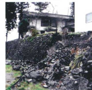
⑦ 玉石積擁壁の崩壊
