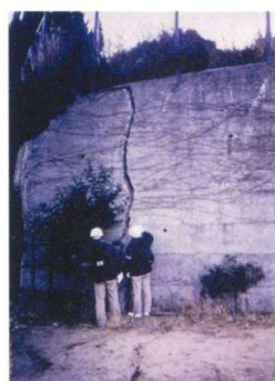
③ コンクリート系擁壁の亀裂
