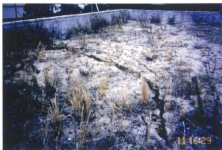
① 宅地地盤の亀裂
