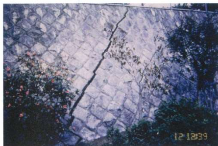
② 練積造擁壁の亀裂
