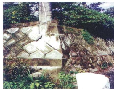
⑤ 電柱が立っている擁壁の崩壊
