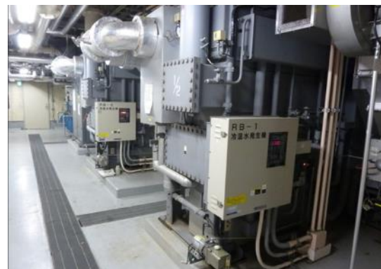
冷温水発生機 (熱源)
