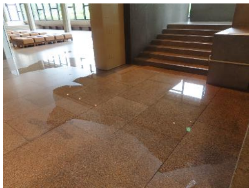
ホワイエ雨漏り (雨水配管劣化)
