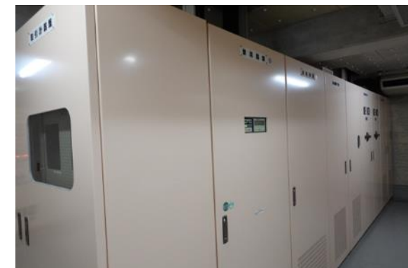
受変電・蓄発電設備
