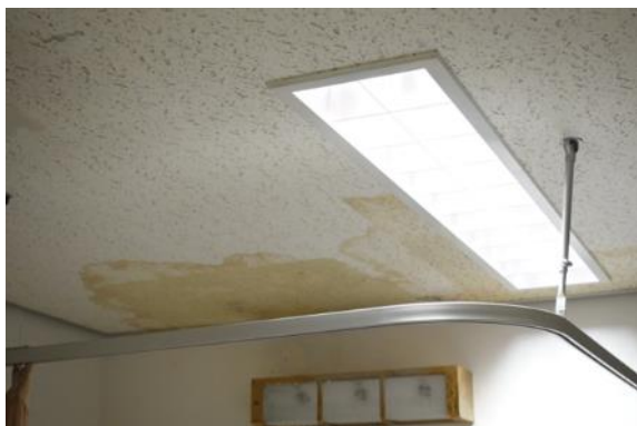
楽屋雨漏り (屋根防水機能劣化)
