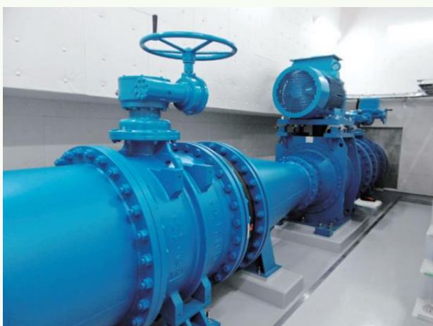
待矢場三栗谷発電所（太田市）
