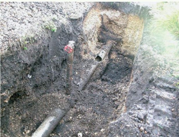
石綿セメント管の破損状況（昭和村）
