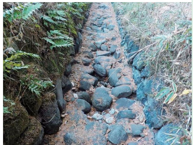
老朽化のため改修が必要な用水路 （前橋市：赤城大沼用水）
