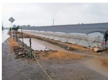
事業実施前 （個人で行った排水対策（簡易調整池））
