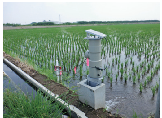
自動給水栓の実証（野辺地区）
