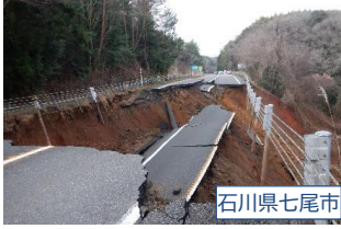
地震による道路盛土の崩落
