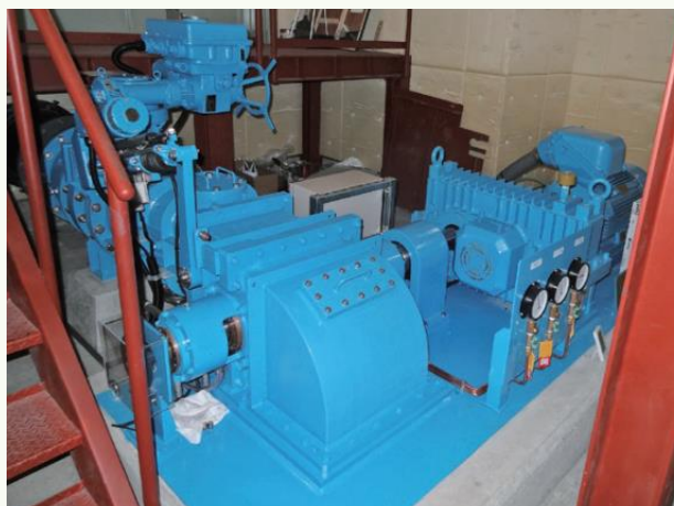
大間々用水神梅発電所（みどり市）
