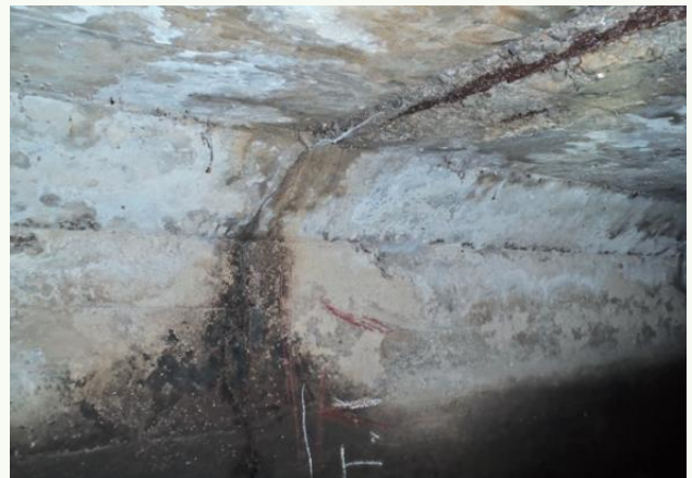
劣化が進んだ水路（高崎市：長野堰幹線水路）
