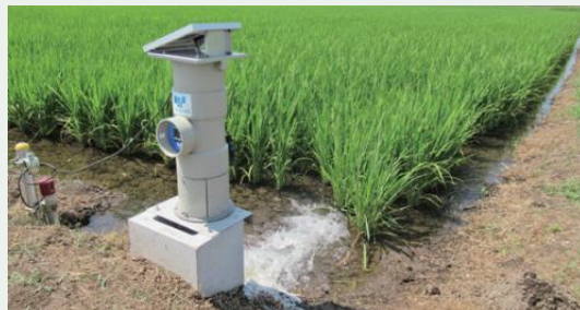
ICT 自動給水栓
