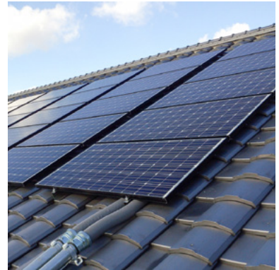
太陽光発電設備（群馬県富岡合同庁舎）
