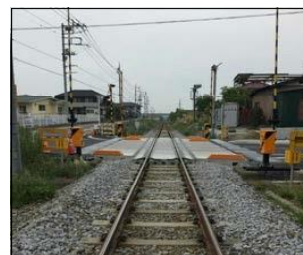
【障害物検知装置の整備】
