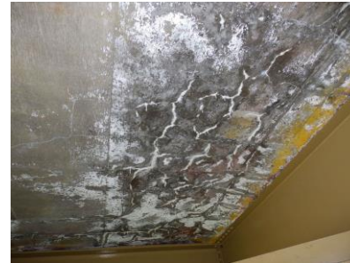
対策実施前(ひびわれ発生状況)
