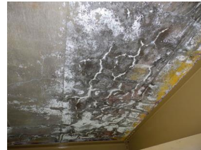
対策実施前(ひびわれ発生状況)
