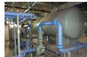
汚泥棟給水設備
