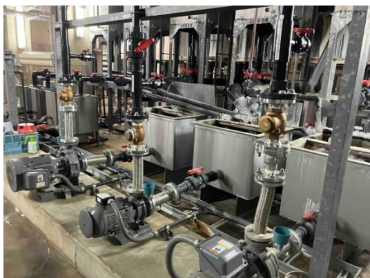
山中温泉の総湯「菊の湯」と市立の福祉センターの間の地下にある集中管理装置。
