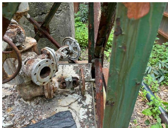
乳頭温泉郷の仙北市所有の蒸気泉。スケールが固まり、一部腐食も進んで、危険な状態になっている。
