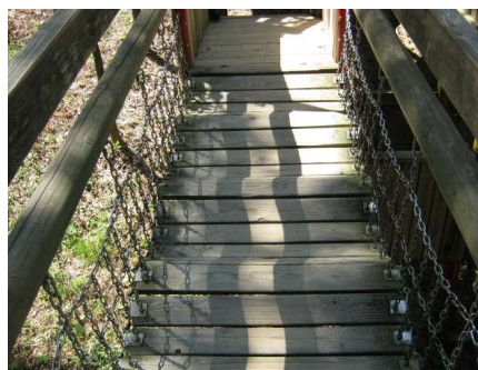
鎖の摩耗、板の抜け落ち
