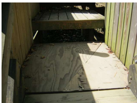
デッキ床のがたつき、抜ける危険
