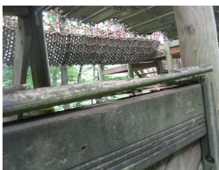
パネルのささくれ、腐食、がたつき
