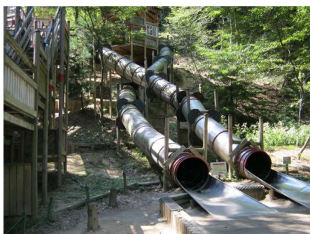
滑り面の引っかかり、支柱のがたつき
