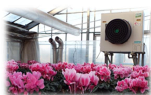
ヒートポンプを導入しているハウス
