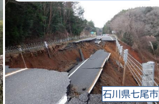
地震による道路盛土の崩落
