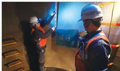
管路内の損傷箇所調査
