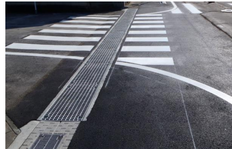
道路冠水対策
