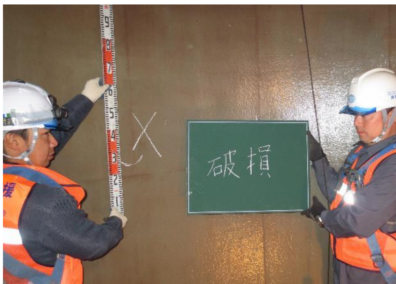
被害状況調査
