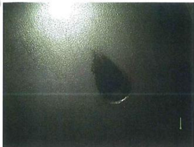
写真(1) ボアスコープポート#28より 圧縮機水抜き穴
