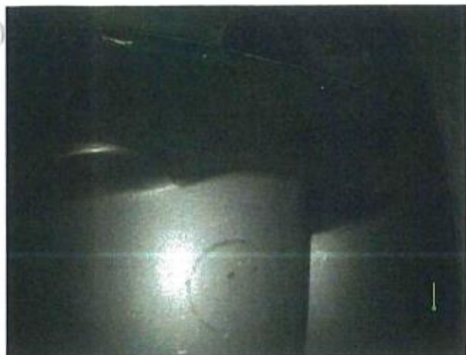
写真(7) ボアスコープポート#28より 圧縮機1段静翼内端
