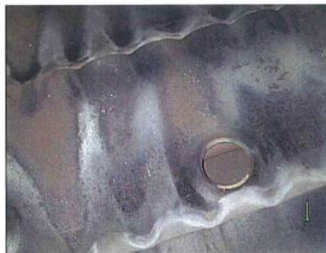
写真(22) 燃料ノズル取外し箇所より 燃焼器内筒状況
