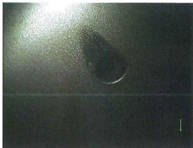
写真(2) ボアスコープポート#28より 圧縮機水抜き穴
