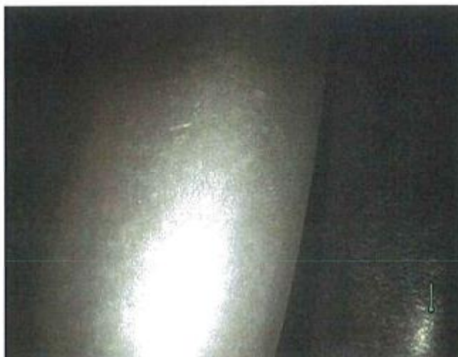
写真(12) ボアスコープポート#23より 圧縮機6段静翼中間部
