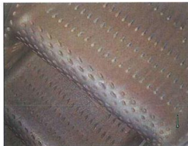
写真(24) ボアスコープポート#12より 高圧タービン1段静翼
