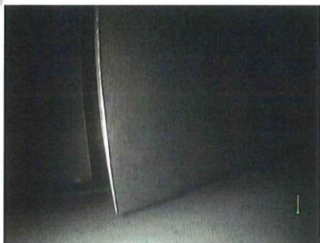
写真(3) ボアスコープポート#28より 圧縮機1段動翼外端
