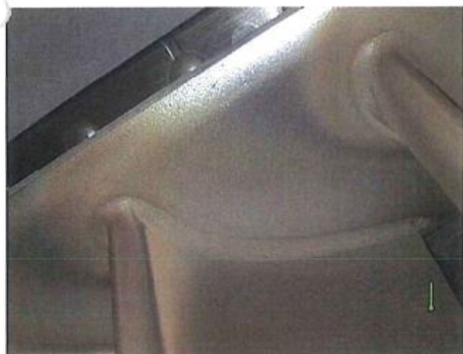
写真(35) ボアスコープポート#10Dより 低圧タービン1段静翼内端
