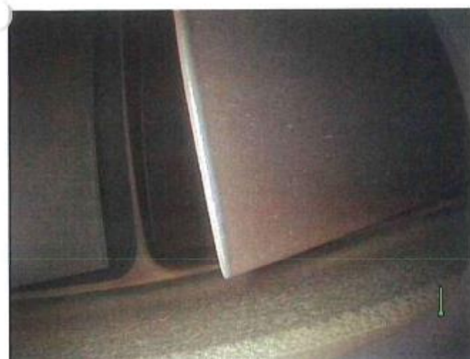
写真(17) ボアスコープポート#14より 圧縮機15段動翼外端
