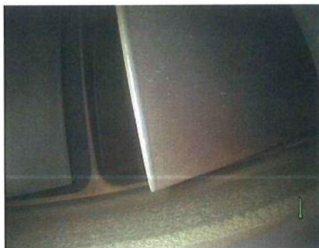
写真(14) ボアスコープポート#14より 圧縮機15段動翼外端
