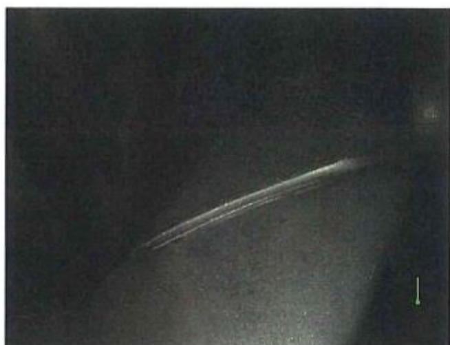
写真(4) ボアスコープポート#28より 圧縮機1段動翼中間ダンパ磨耗パット状況
