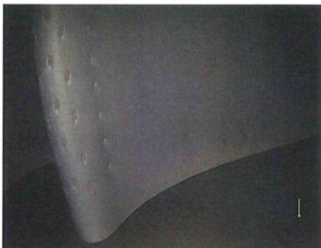
写真(28) ボアスコープポート#12より 高圧タービン1段動翼外端
