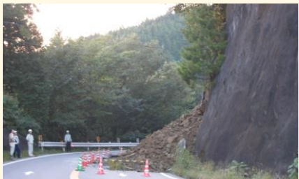
事業前の状況 (H18.10発生の斜面崩壊)
